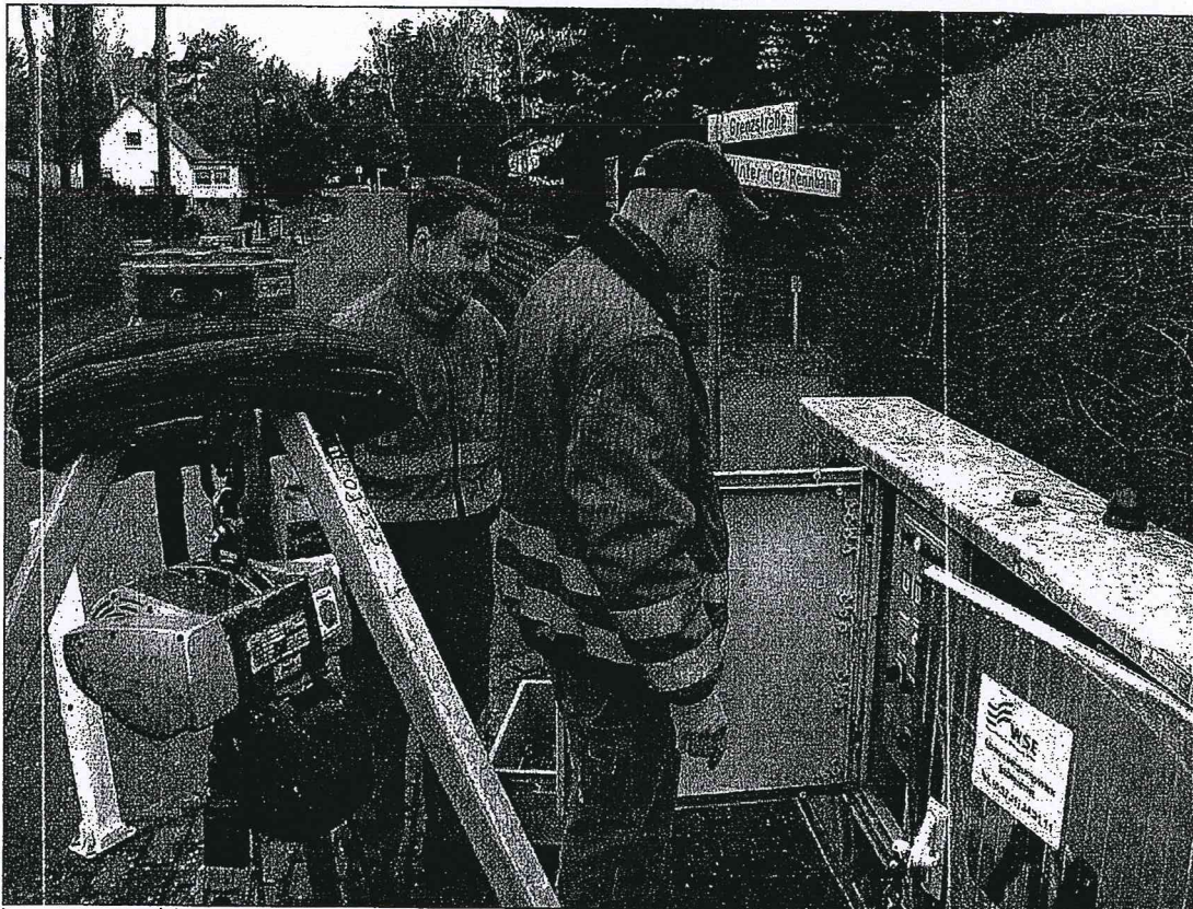
Am Schaltschrank: Toni Springer (vorn) und Robert Vsetycek vom Bereitschaftsdienst Schmutzwasser des Wasserverbands Strausberg-Erkner müssen die Pumpen zunächst ausschalten. Danach werden sie herausgehievt und kontrolliert.
